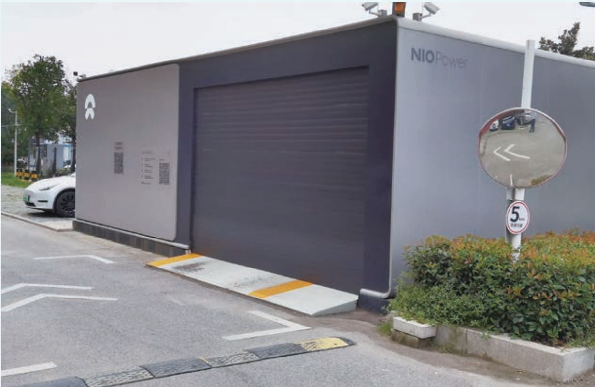
武漢蔚能電池資產管理有限公司動力電池直租項目
